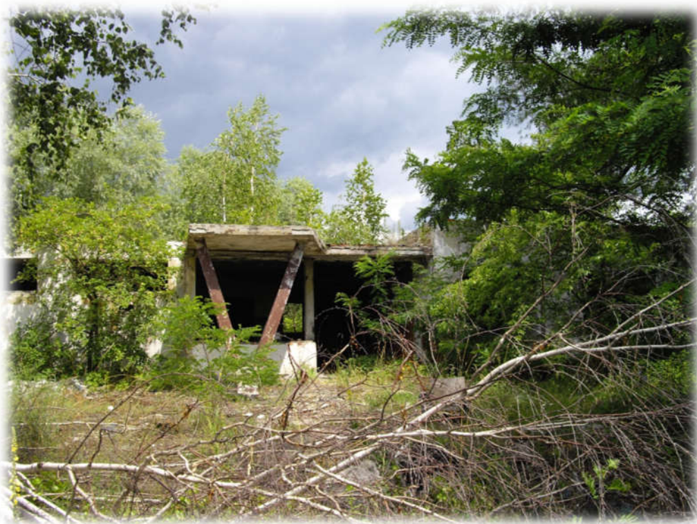
Ryc. 5 Budynki w ruinie przy ul. Strefowej (źródło: własne)
